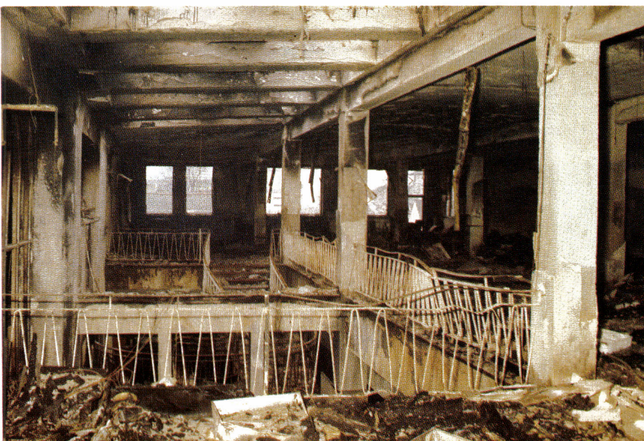
Die Temperaturen erreichten zum Zeitpunkt des „flash-over“ bis zu 1300 Grad Celsius. Die gesamte Brandlast wurde total vernichtet. Foto: FF St. Pölten-Stadt
