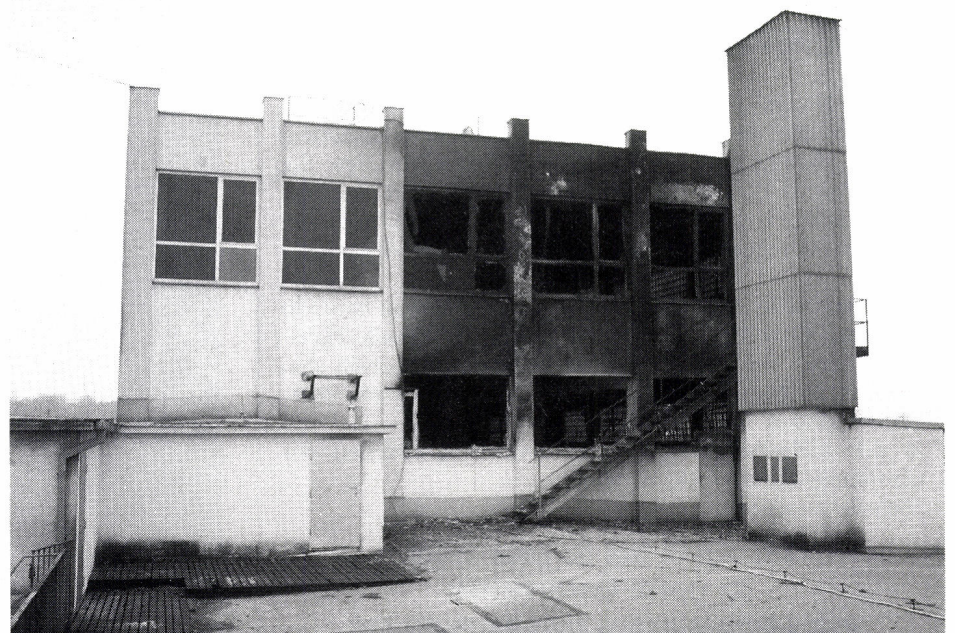
Das überbaute 4. und 5. Obergeschoß mit der Fluchttreppe, die 20 Menschen das Leben rettete.
