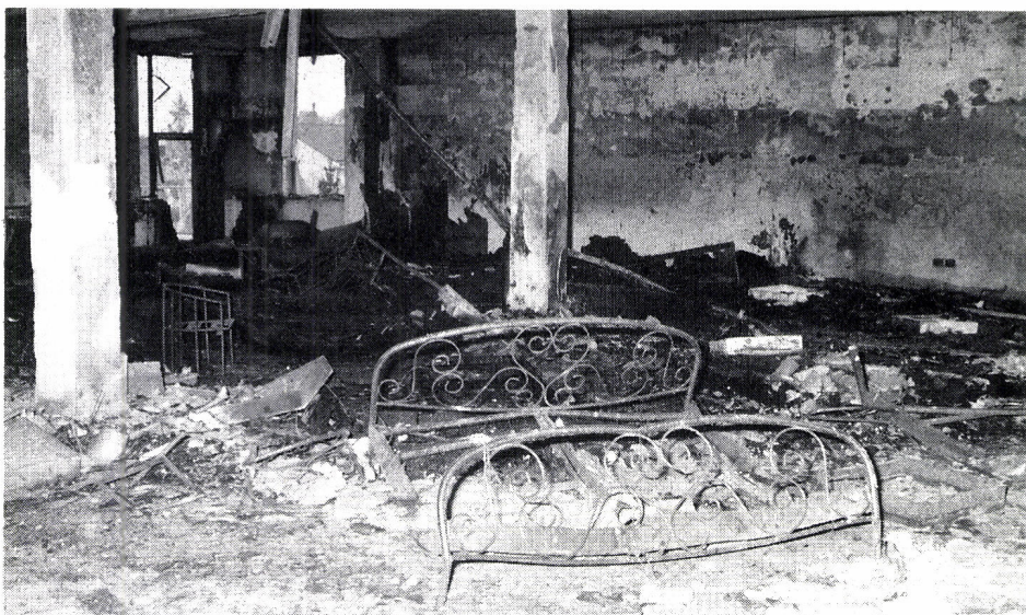
Ein Metallrahmen in der Bettenabteilung ist übriggeblieben. Foto: FF St. Pölten-Stadt
